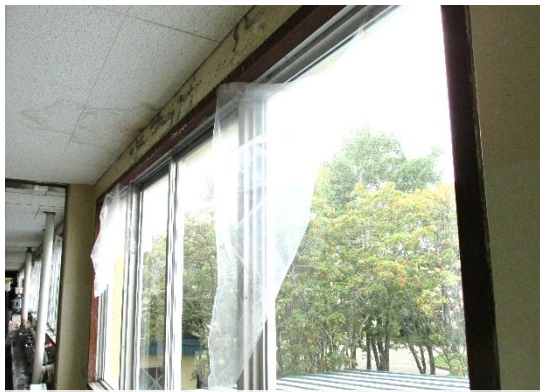
白黒印刷なので見えにくいですが、廊下の窓に何枚も雨除けのビニール袋がかかっています。天井や梁も何か所も雨漏りで変色しています。
