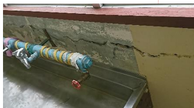
小学校の水飲み場 壁に大きな亀裂がある
