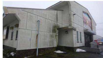
北方領土資料館-安全性に問題は無いそうだが、外壁が黒ずんで汚れているなど古く傷んでいる様子。
