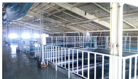
桂木→ 浄水場 (内部)
